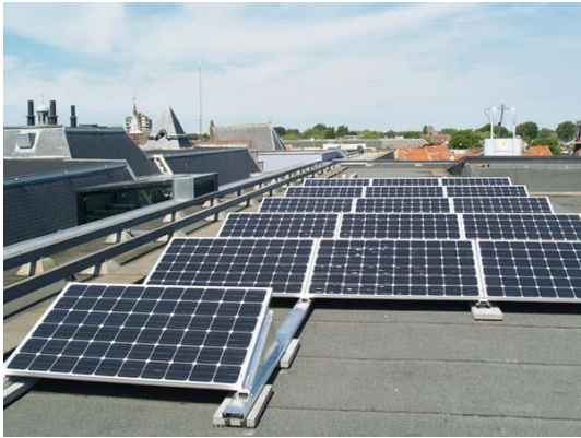
Figuur 5.2-4 Energieproductie – zonnepanelen
